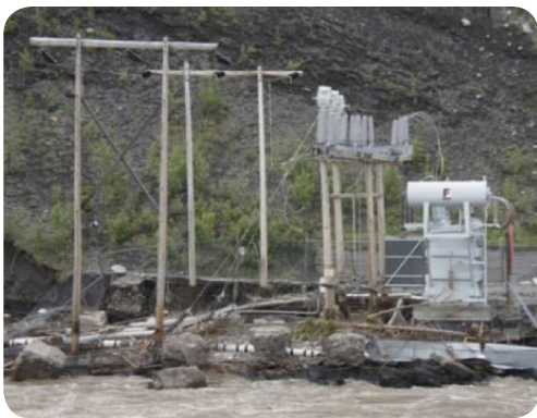
Figure CS1.1 Poste électrique Barrier 32S endommagée par une inondation, juin 2013 5
