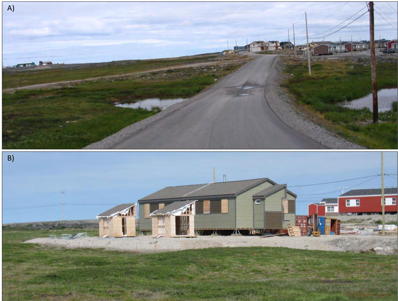
Figure 23: A) Route affectée par des tassements importants dans une dépression mal drainée comblée de sédiments marins fins riche en glace et où l'accumulation d'eau de part et d'autre favorise la thermo-érosion du pergélisol. B) Maison construite dans un secteur où le pergélisol est riche en glace. L'épaisseur du radier n'est pas suffisante pour permettre la remontée du pergélisol à l'intérieur de celui-ci rendant précaire la stabilité de l'infrastructure.
